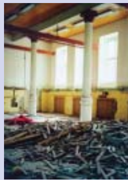
Tělocvičnu v ZŠ Pernerova čeká po povodni rozsáhlá rekonstrukce.
