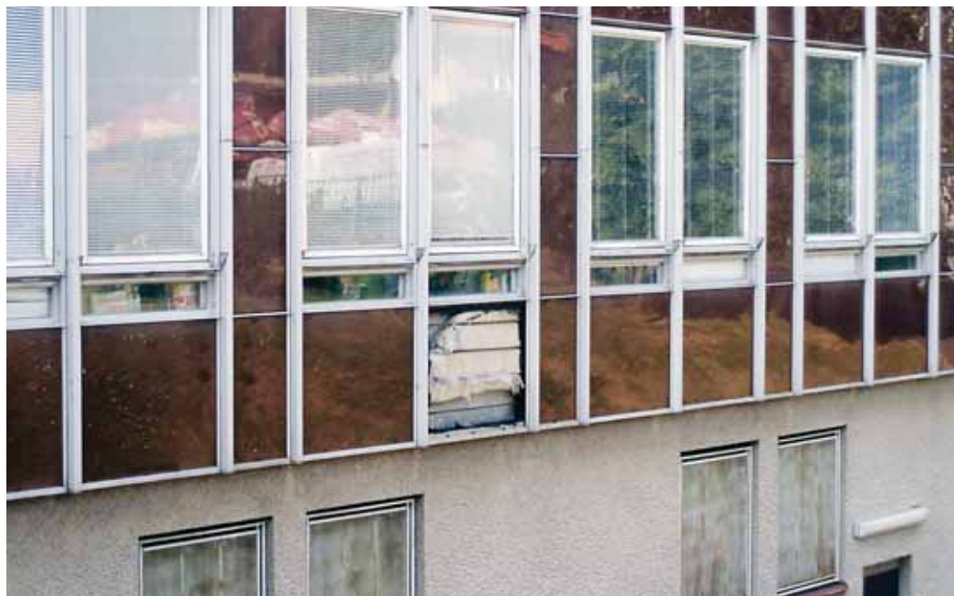
Plášť Základní školy Na Šutce nespĺňuje současný trend energetických úspor
